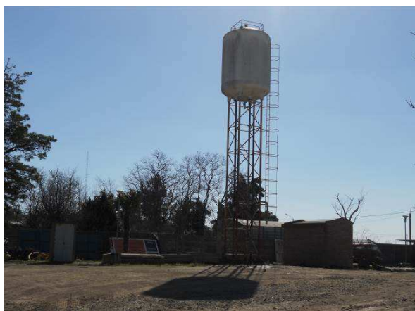
Figura 51. Pozo N° 1 Obras Sanitarias sede Gardey.
